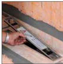
=> 1. Mettre en place le cadre avec les blocs en polystyrène pour maintenir son écartement
