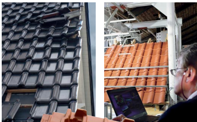
Dégâts causés par la tempête
